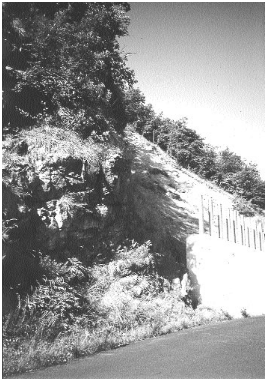
Fig. 5 - Movimenti franosi lungo la strada provinciale causati dal dissesto idro-geologico.
