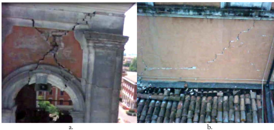
Figura 15. Due esempi di immagini ravvicinate acquisite mediante UAV, per l'accertamento di danni sismici a edifici storici nel comune di Camposanto (Modena). Nell'immagine (a), lesioni alla parte alta della torre campanaria della chiesa di San Nicola da Bari. L'edificio era situato nella "zona rossa" stabilita dal Comune; la stazione di controllo e osservazione dello UAV era stata collocata quindi su un argine del fiume Panaro, a circa 50 m di distanza. Nell'immagine (b), dettaglio di una lesione alla base della c.d. "Torre Ferraresi". La particolarità di questo caso, in cui la stazione di controllo dello UAV era nel cortile retrostante il manufatto, è che la frattura risultava del tutto invisibile da terra e avrebbe richiesto, in assenza del drone, una ispezione autoptica condotta inviando un operatore sul tetto dell'edificio circostante la torre; ciò il 2-3 giugno 2012, nella fase più intensa dello sciame sismico
